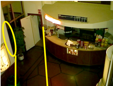
Elcentralen vid kassan.
